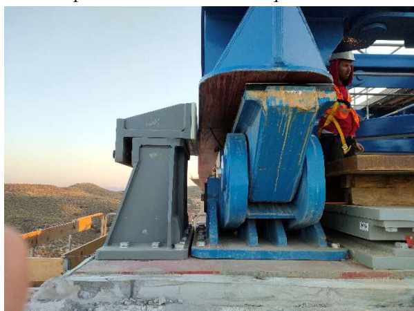
Figura 11. Llegada del frente de la nariz a pila.
