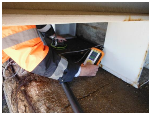
Figura 9. Lecturas de corrosímetro
