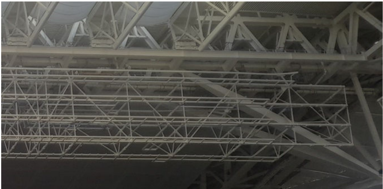
Figura 6. Estructura de laterales rodeando a los puntales de apoyo de la cercha de rodadura.
