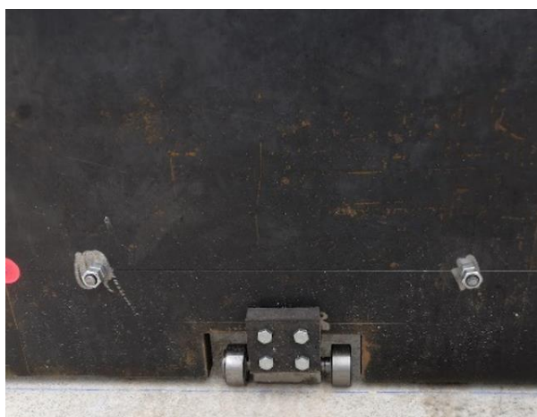
Figura 4. Vista del sistema de rodadura.
