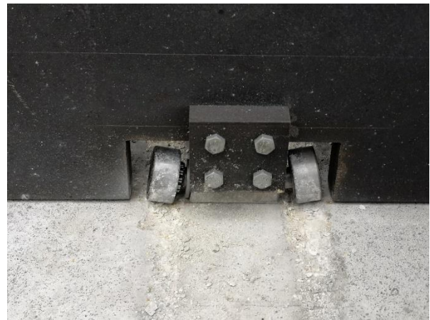
Figura 12. Daños en el sistema de rodadura (fase de ensayos I)
