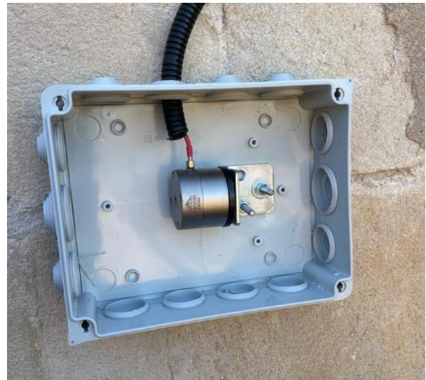
Figura 3. Detalle de acelerómetro instalado.
