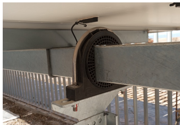
Figura 13. Fotografía de una de las rótulas del seguidor solar.
