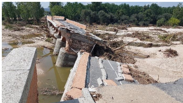
Figura 1. Colapso del puente de La Pedrera tras la DANA (Septiembre de 2022).
