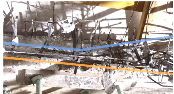
Figura 6. Disposición de la armadura longitudinal de un nervio tras la demolición de un nervio.
