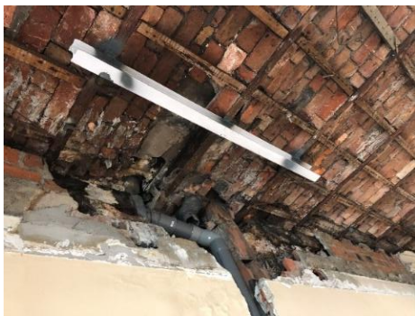
Figura 5. Detalle de intervención de apeo en viguetas con corrosión severa.
