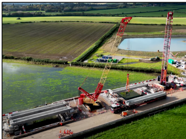
Fig.13. Montaje sobre llanura inundable (TVV).
