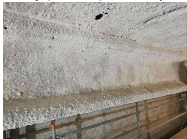
Figura 8. Vista lateral donde se infiere la separación de estribos originales inexistentes en viga V1 y oquedad en placa alveolar
