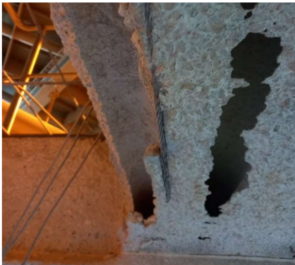
Figura 9. Oquedad en placa alveolar con pérdida completa de losa inferior y con alveolos abiertos y alambres de PT a vista
