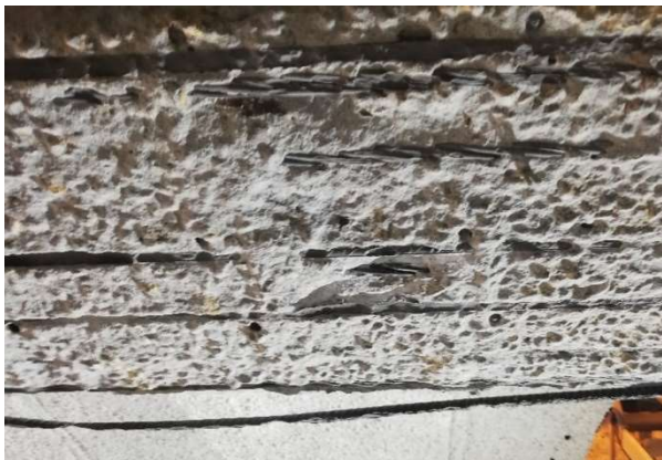
Figura 5. Cara inferior de viga V1-100 con afectación de armadura pasiva y activa.
