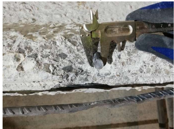
Figura 7. Detalle de armadura pasiva inferior de flexión que presenta daño por corrosión biogénica
