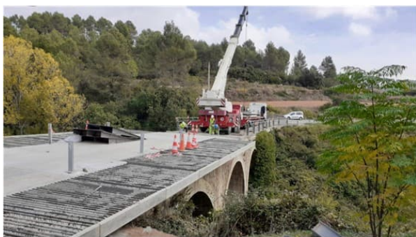
Figura 6. Rampas metálicas auxiliares.
