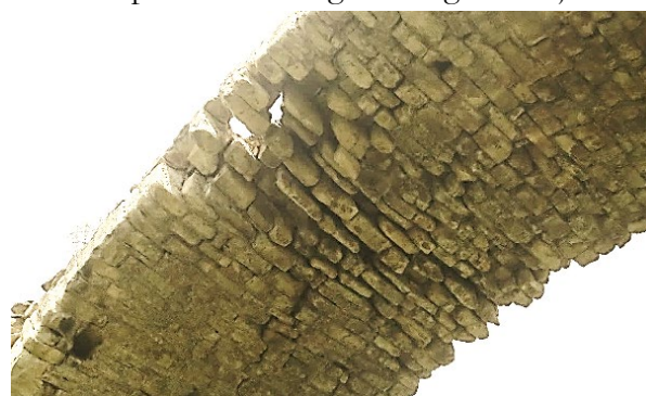
Figura 3. Intradós de bóveda previa al derrumbe.
