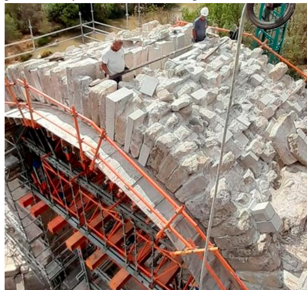
Figura 14. Vista de la bóveda faltando las hiladas centrales del interior. Las dovelas de clave de las boquillas están presentadas, no amorteradas.
