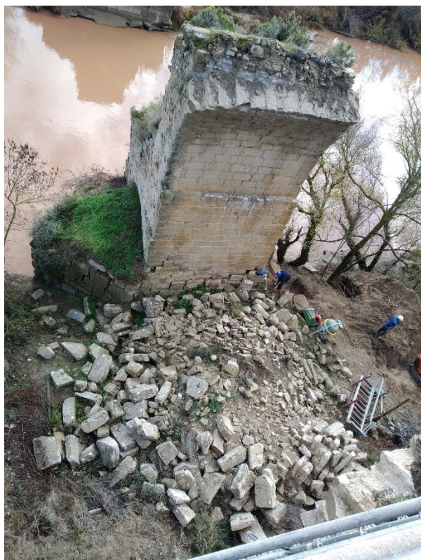
Figura 4. Escombros de la bóveda.
