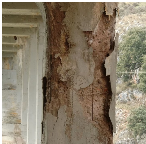
Figura 4. Avance del deterioro en 2016
