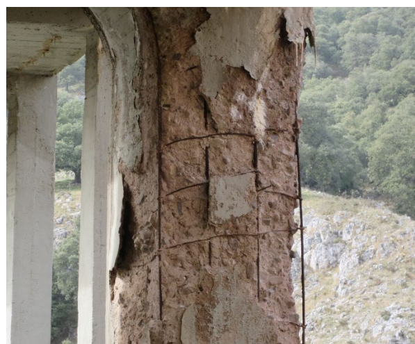
Figura 5. Avance del deterioro en el mismo punto de la foto anterior en 2021
