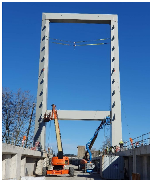
Figura 5. Mástil de atirantamiento.
