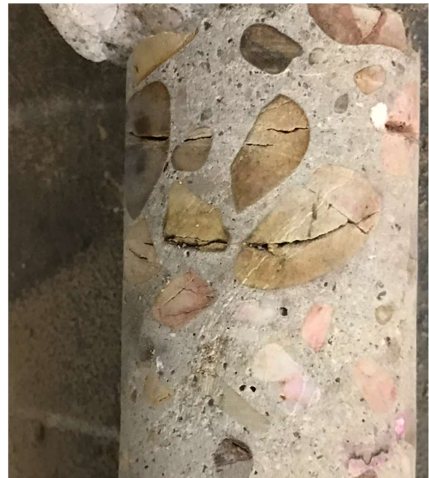
Figura 3. Imagen afección por árido álcali.
