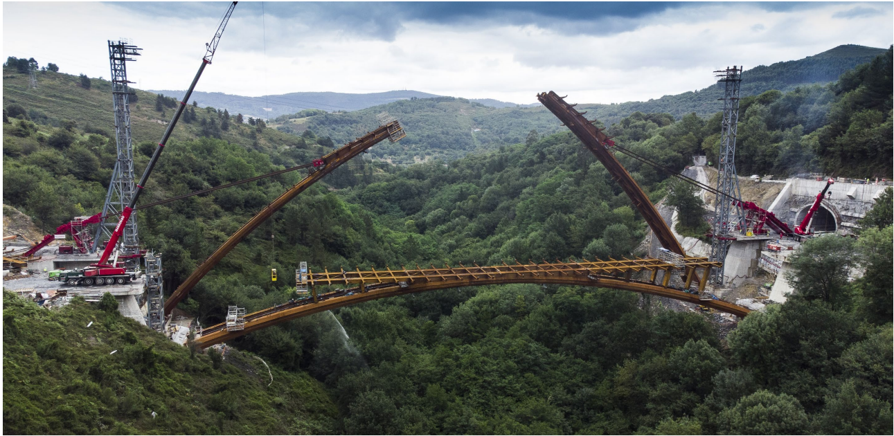
Figura 24. Vista general abatimiento
