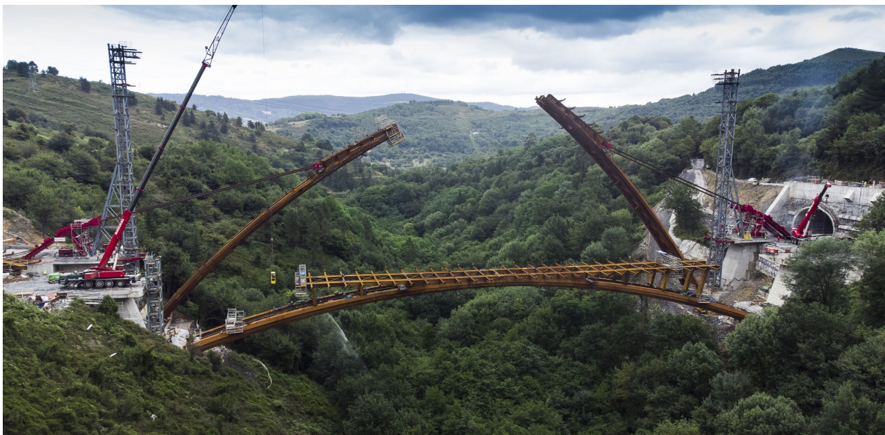
Figura 18. Vista general abatimiento
