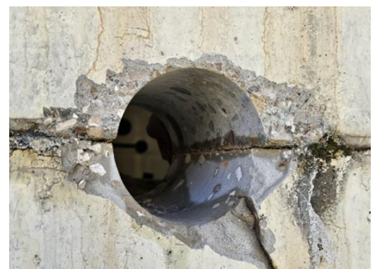
Figura 9. Obsérvese la humedad existente en la junta fría
