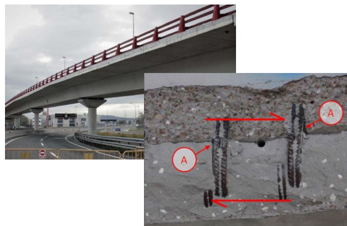
Figura 2. Fallo a rasante en una de las vigas artesa de un puente construido en el año 2011
