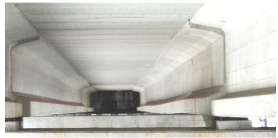
Figura 5. Obsérvese la acusada deformación que presentaba una de las vigas que presentaba mayores defectos
