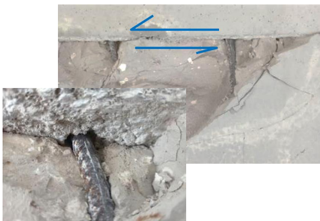
Figura 7. Cala realizada en torno a algunos desconchones existentes en una de las juntas frías
