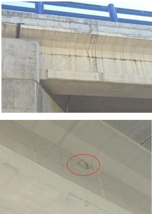
Figura 4. Vistas de algunas de las fisuras y desconchones detectados en las vigas, en torno juntas de hormigonado
