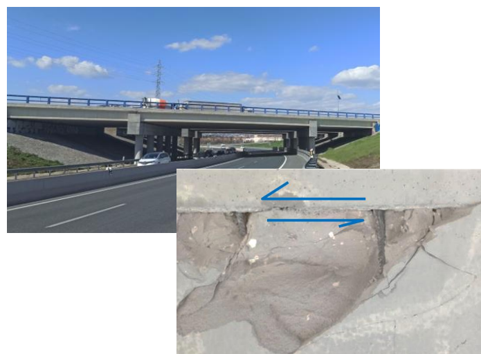
Figura 3. Fallo a rasante en una de las vigas en doble T de una de las estructuras de la A-4 en las proximidades de Córdoba
