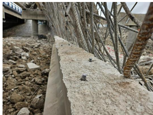
Figura 12. Obsérvese la extensión y horizontalidad de una de las juntas frías, así como su aspecto superficial
