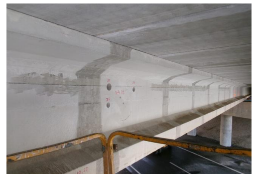
Figura 8. Obsérvese la existencia de varias juntas de hormigonada en el alma de la viga
