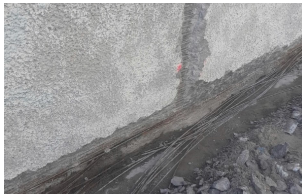
Figura 8. Deterioro en base de muro y roza vertical.
