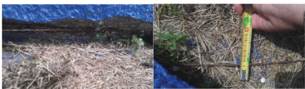
Figura 6. Alambres vistos en base de muro.
