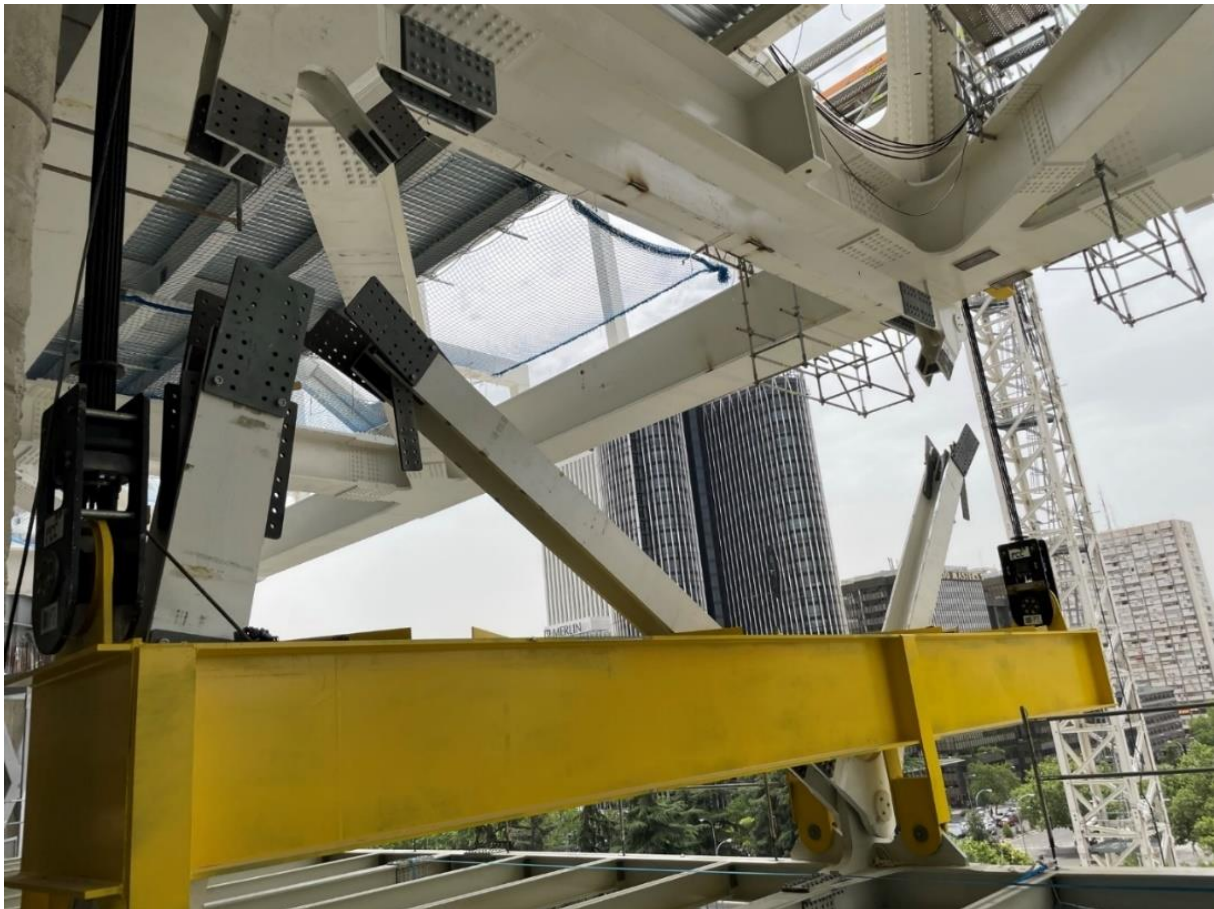
Figura 14. Conexión cuelgues verticales viga museo pendientes de realizar
