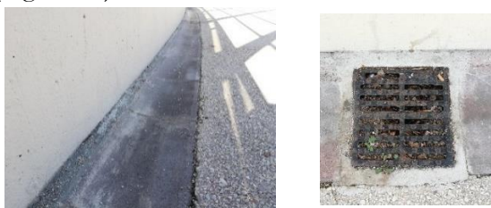
Figura 19. Caz de hormigón (izquierda) y sumidero obturado (derecha) en el puente de la Lira.
