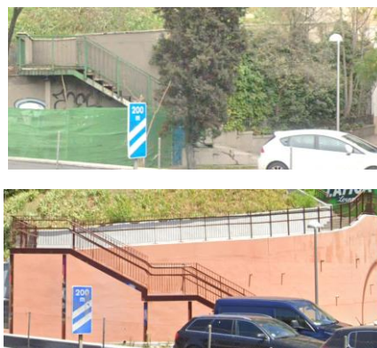
Figura 21. Eliminación de puntos ciegos en el camino existente en la calle Virgen de la Paz.
