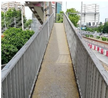
Figura 14. Anchura insuficiente de la rampa (pasarela Avenida de América – Parque de las Avenidas sobre A-2).
