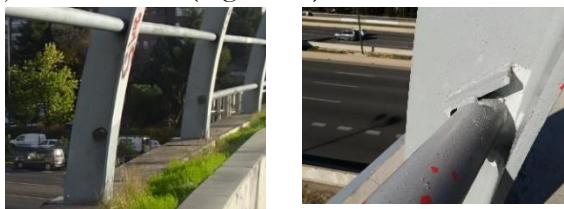
Figura 20. Ausencia de barra en cerramiento (izquierda) y pieza en extremo de la barra para evitar su retirada (derecha) en el puente de la Lira.
