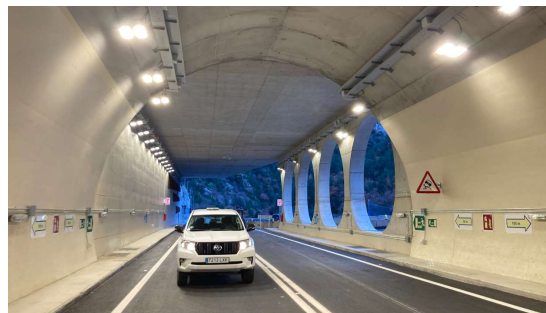
Figura 33. Transición entre túnel y falso túnel, ya con las instalaciones y en servicio.
