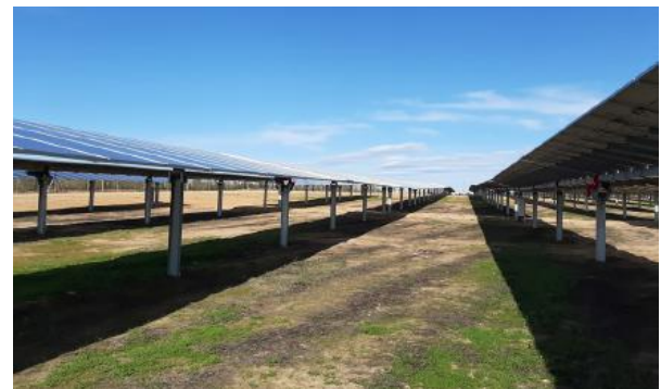
Figura 1. Seguidores solares fotovoltaicos de un eje horizontal
