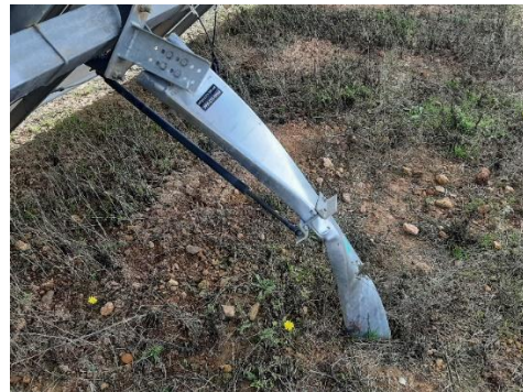
Figura 5. Pandeo por torsión en soportes cuando se alcanzan grandes desplazamientos en el giro del eje del seguidor.
