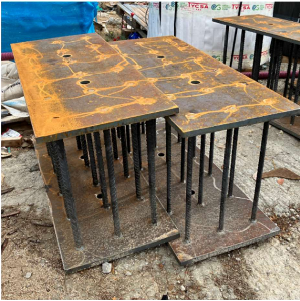
Figura 11. Chapas de unión celosía a forjado.
