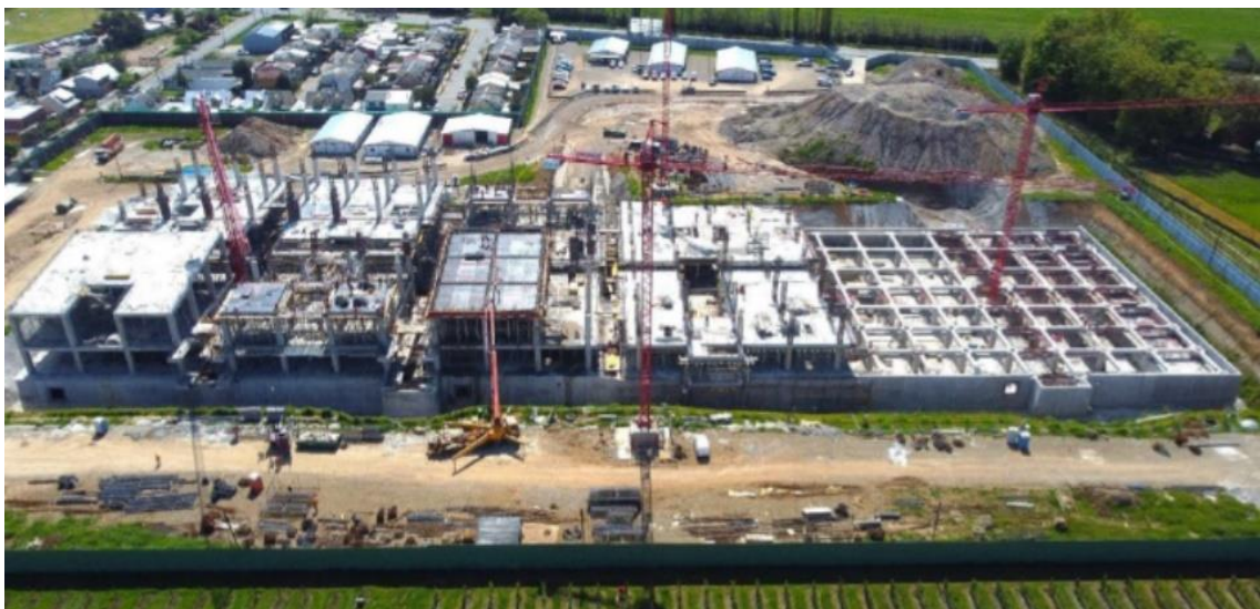
Figura 6. Estructura sobre aislamiento y bajo aislamiento del Hospital de Parral
