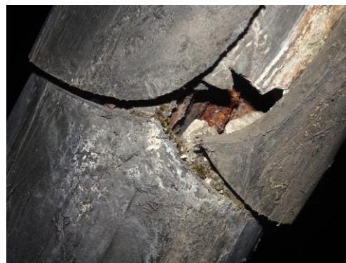
Figura 8. Vista del interior de la vaina. Falta de inyección y corrosión de los alambres.
