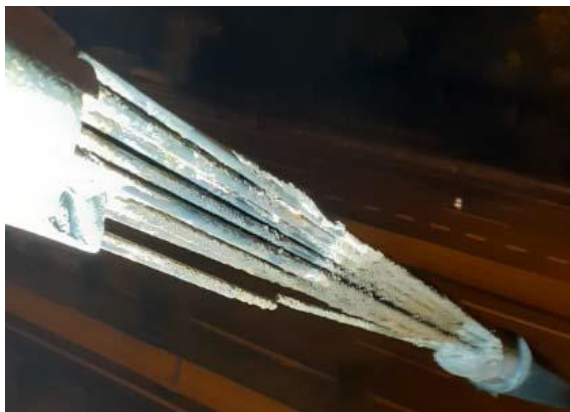
Figura 9. Estado de los alambres. Corrosión generalizada y rotura de 1 alambre.
