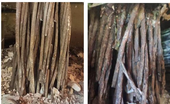
Figura 5. Corrosión generalizada y rotura de varios alambres.
