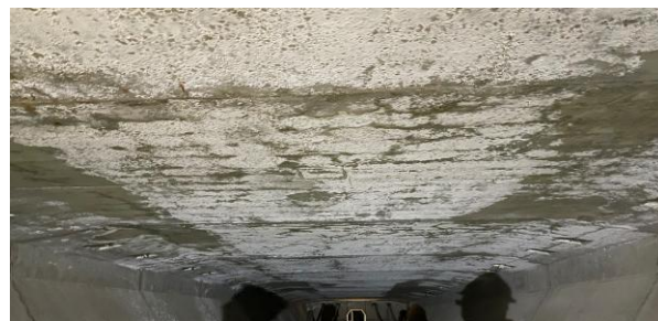
Figura 4. Humedades y eflorescencias en la cara interior de la losa superior.
