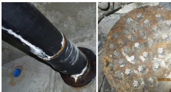
Figura 1. Corrosión y eflorescencias en zonas de anclaje (izquierda) y cabeza de anclaje con corrosión (derecha).
