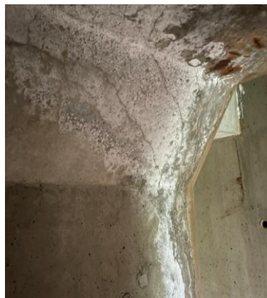
Figura 11. Fisuración por esfuerzos en los pasos de hombre de ciertos mamparos.
