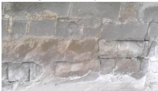
Figura 6. Lavado de llagas bajo puente de fábrica en el municipio de Tudela.
