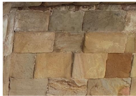
Figura 7. Erosión de sillares en puente de fábrica situado en el municipio de Soria.
