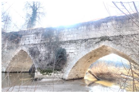
Figura 5. Vegetación enraizada en el puente Mediana sobre el río Eresma.
