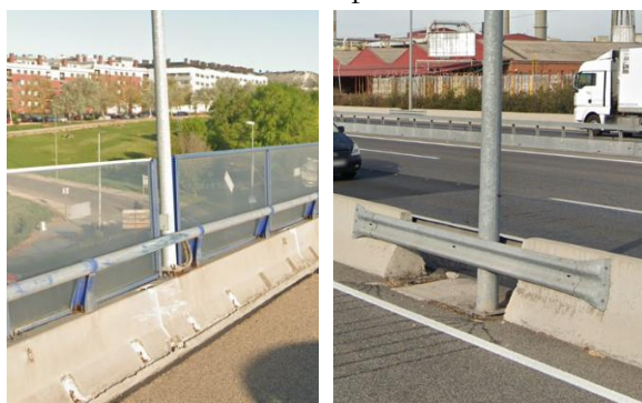
Figura 8. Ejemplo elementos dispuesto sobre o entre los sistemas de contención.
