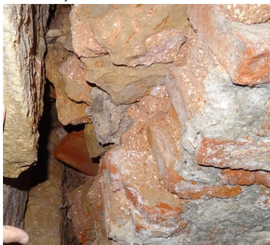
Figura 11. Pérdida de piezas
