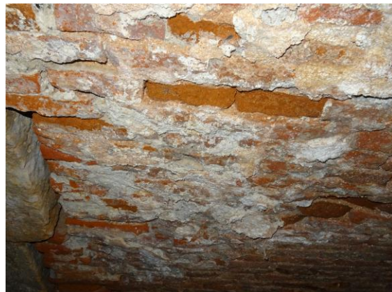
Figura 9. Erosión generalizada, eflorescencias y restos de mortero cementoso.
