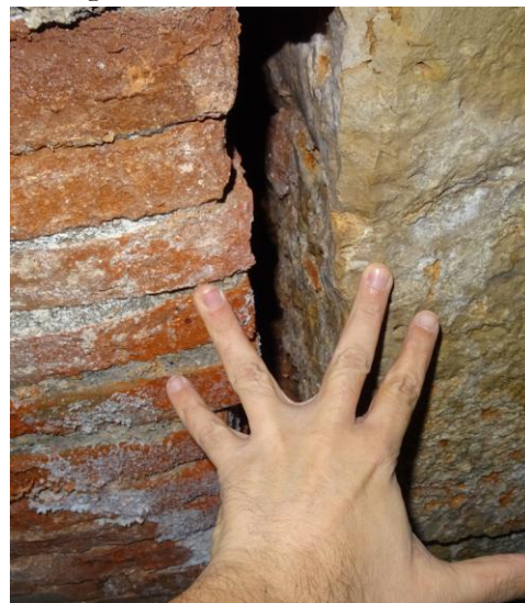
Figura 10. Grieta bóveda-boquilla en el lado de la ampliación.
