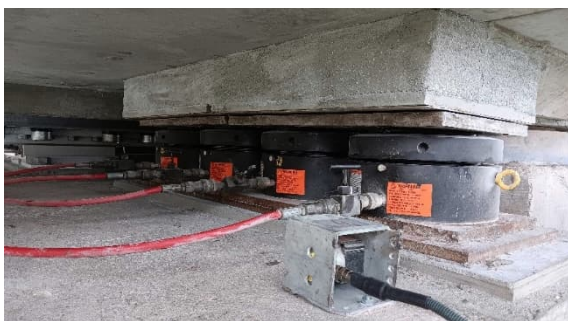
Figura 14. Cilindros hidráulicos con sistema de deslizamiento.
