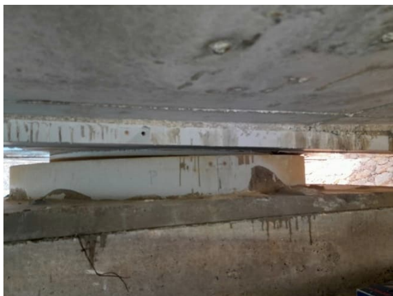
Figura 2. Apoyo derecho de P1 con exceso de giro.
