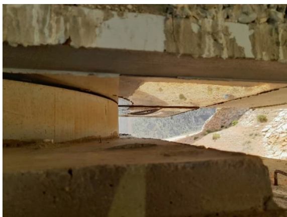
Figura 3. Abolladura en placa de deslizamiento de apoyo derecho de pila 1.
