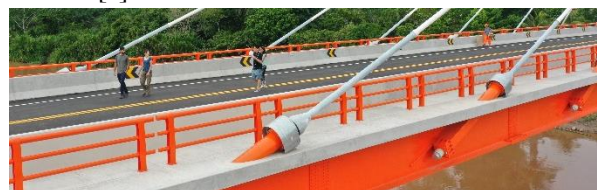
Figura 6. Detalle de los amortiguadores de fricción instalados en los tirantes T09 y T10.
