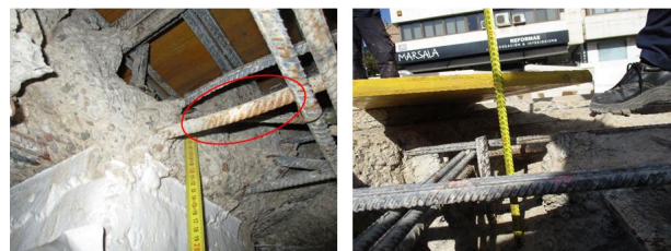
Figura 5. Vistas de algunas de las calas realizadas. Se señala en rojo el tramo horizontal de la armadura de punzonamiento, caída.
