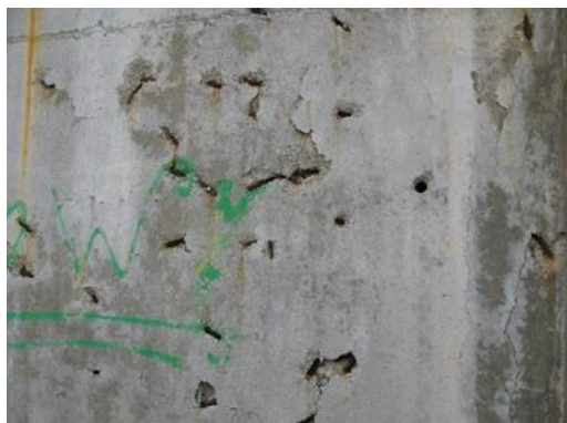
Figura 3. Falta de recubrimiento en las patillas
