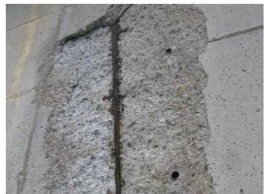
Figura 2. Falta de recubrimiento
