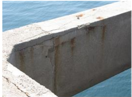
Figura 11. Corrosión en aristas
