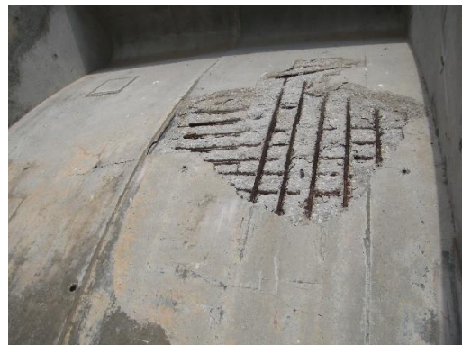
Figura 12. Corrosión en zonas curvas
