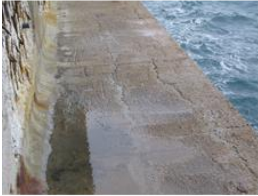
Figura 9. Falta de bombeo en la solera
