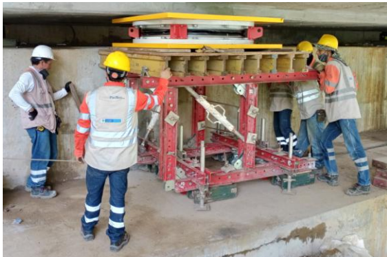
Figura 18. Descenso de apoyos
