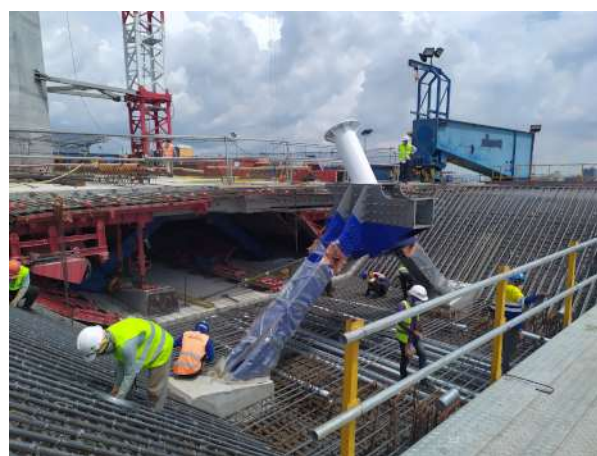
Figura 14. Marco interno anclaje tirantes.
