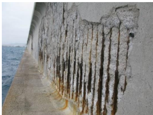
Figura 1. Pérdida de recubrimiento por intensa corrosión del armado, tras 13 años de servicio. Espaldón A.
