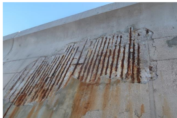
Figura 2. Pérdida del recubrimiento debido a la intensa corrosión del armado, tras 16 años de servicio. Paramento exterior del espaldón D.
