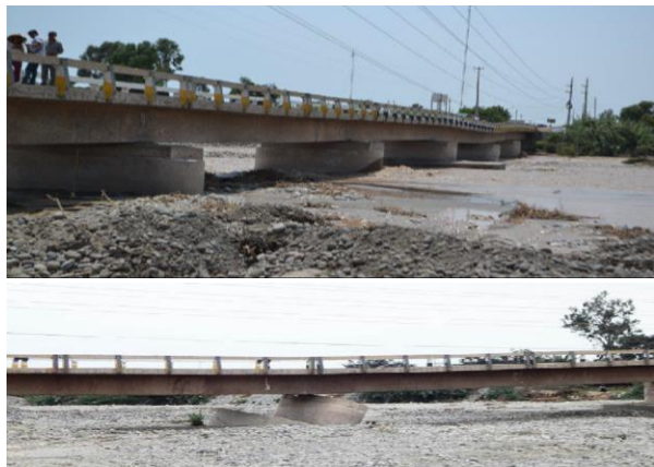
Figura 1. Estado del Puente Chamorro posterior al fenómeno de El Niño Costero en el año 2017.
