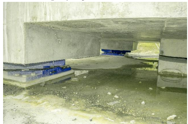
Figura 9. Aisladores en la base de pilas cortas.
