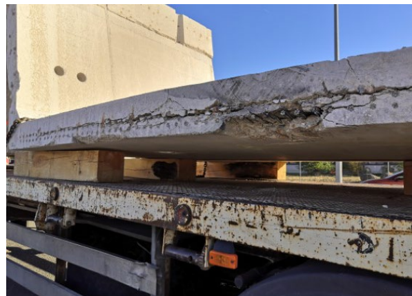
Figura 21. Hendimiento en viga apeada tras corte en rebanadas con hilo de diamante
