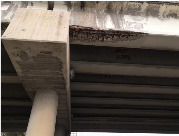
Figura 9. Corrosión y rotura de armaduras pasivas en la zona de máximo cortante
