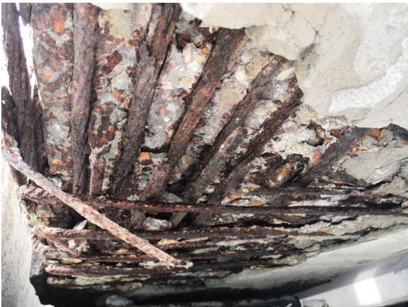
Figura 10. Rotura de cercos de cortante en la zona de máximo cortante junto a apoyos de pila
