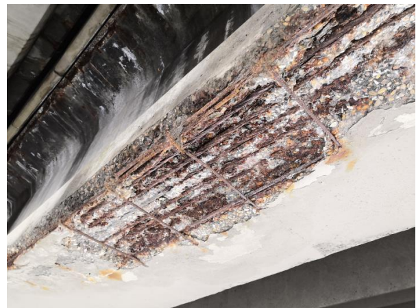
Figura 8. Corrosiones y rotura de tendones de pretensado en el centro de vano del vano central
