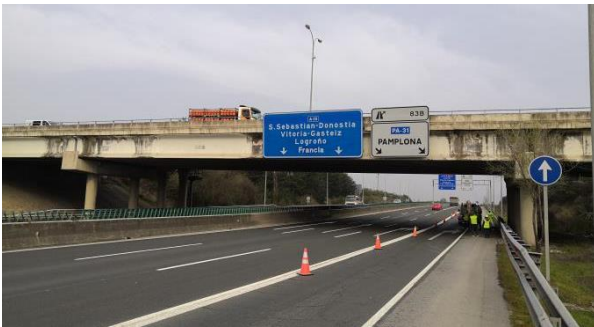
Figura 5. Humedades activas en las vigas de borde derecho
