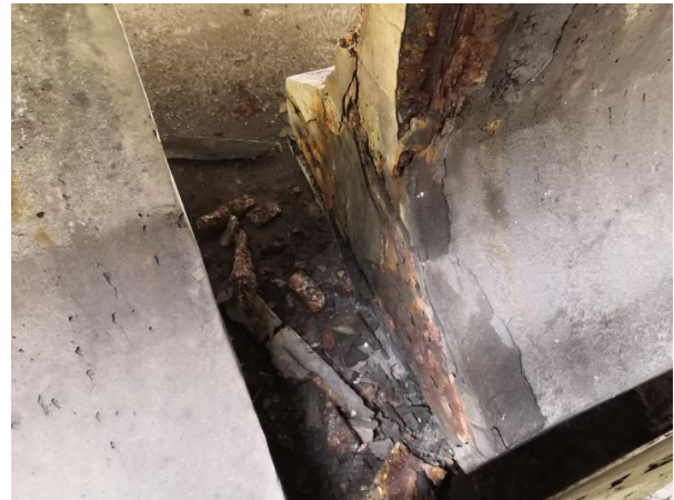
Figura 11. Desprendimientos del recubrimiento y corrosión en la zona de entrega de vigas sobre pilas
