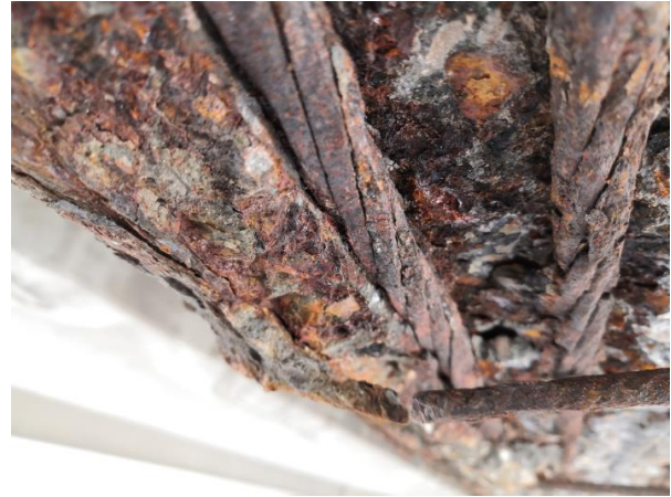
Figura 7. Detalle de corrosión con picaduras de óxido característico del ataque por cloruros
