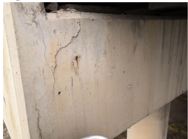
Figura 12. Fisuración, corrosión y desprendimiento del recubrimiento en los dinteles de pilas
