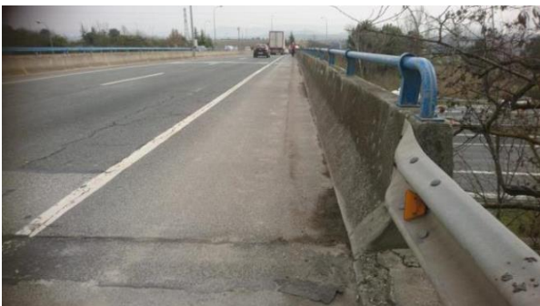
Figura 6. Arcén derecho de la plataforma sin sumideros de drenaje
