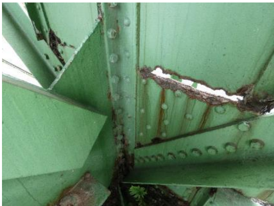
Figura 9. Perforaciones en las chapas del mamparo de pila del lado aguas arriba
