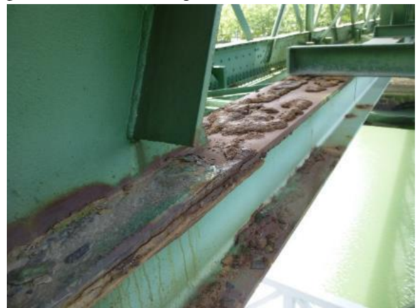
Figura 8. Corrosión y pérdida de sección en cordón inferior de celosía central
