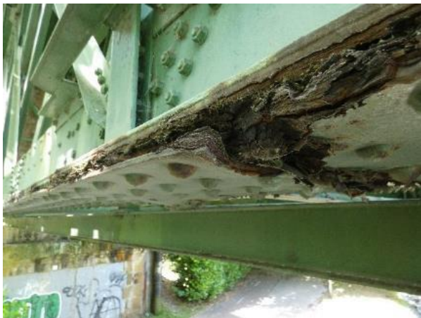
Figura 6. Corrosión y pérdida de sección en cordón inferior de celosía lateral
