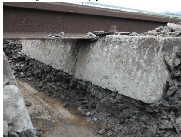
Figura 12. Rotura de traviesas bajo carril
