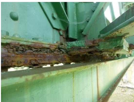
Figura 10. Corrosión en cartelas de unión de arriostramientos inferiores con el cordón inferior
