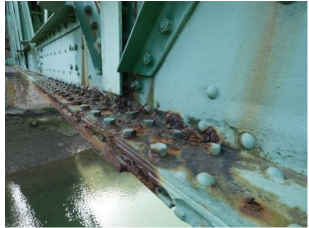
Figura 7. Acumulaciones de agua en el ala inferior del cordón inferior de las celosías exteriores
