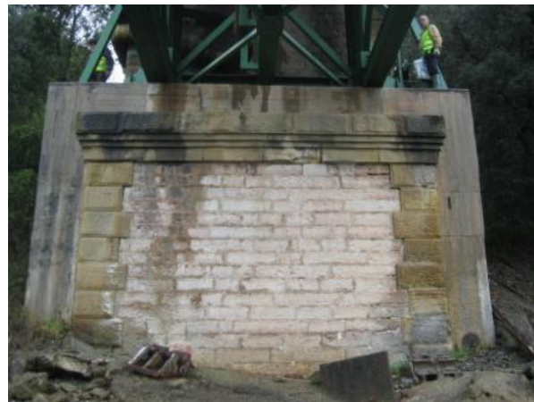
Figura 11. Daños leves en estribos y pila
