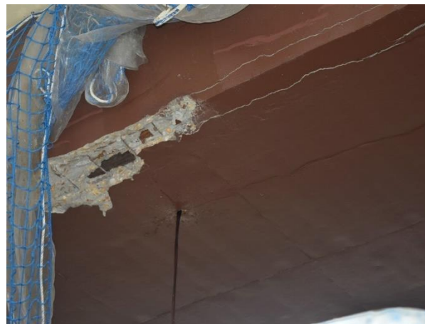
Figura 19. Drenaje del alvéolo contiguo al tendón roto en vano 6. Foto de los autores, 12.02.2020.
