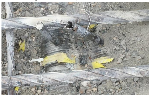
Figura 9. Vainas y tubos de purga sobre pila 6. Armadura pasiva estirada en frío, típica de la época (foto de los autores, 12.02.2020).
