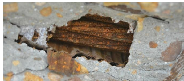
Figura 11. Aspecto de otro tendón sin inyección. Foto de los autores, 12.02.2020.
