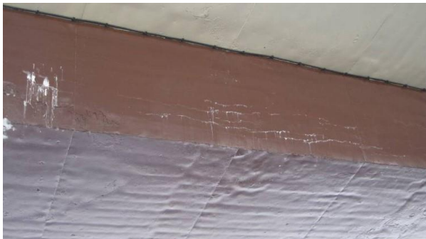
Figura 5. Fisuras longitudinales (foto del informe de inspección principal de INES Ingenieros, 2012).
