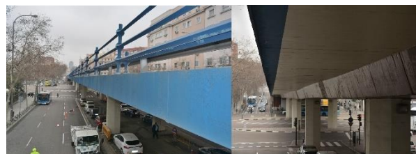
Figura 17. Correcta alineación de la estructura, sin flechas apreciables. Foto de los autores 12.02.2020.
