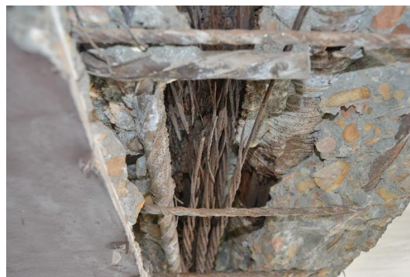
Figura 8. Tendón roto, sin lechada, detectado tras practicar una calicata en la zona de la figura 7.
