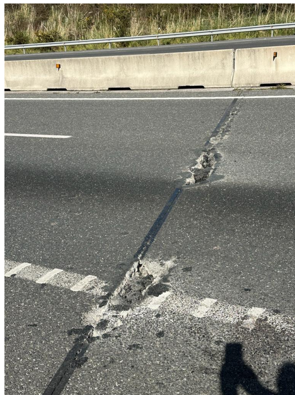
Figura 3. Signos de deterioro en la junta entre los Tramos 2A y 2B.
