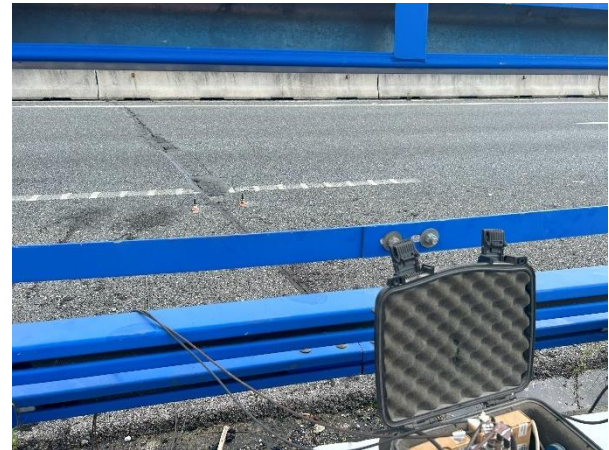
Figura 8. Acelerómetros instalados en la junta entre el Tramo 2A y 2B.
