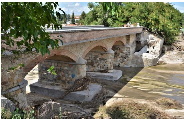
Figura 1. Escorzo desde estribo sur, aguas arriba del pontón después los efectos catastróficos de la dana.
