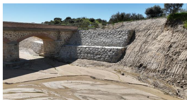
Figura 12. Muros de escollera en el estribo 2 (lado derecho)
