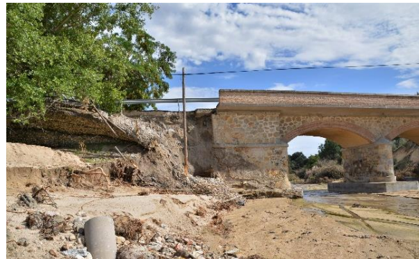
Figura 2. Vista aguas abajo del pontón después los efectos catastróficos de la dana.
