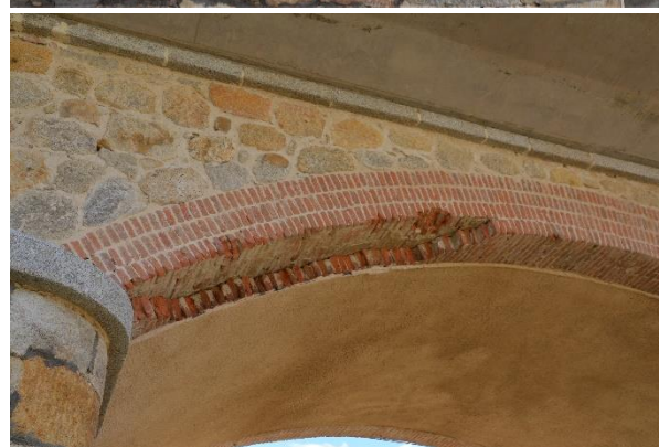
Figura 10. Aspectos diversos de los daños en la primera rosca de ladrillo visto
