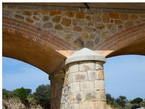
Figura 17. Reconstrucción de las roscas de boquilla
