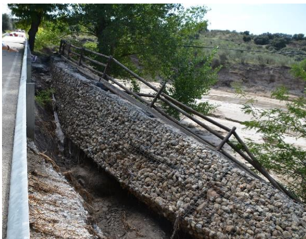
Figura 7. Vuelco del muro de gaviones
