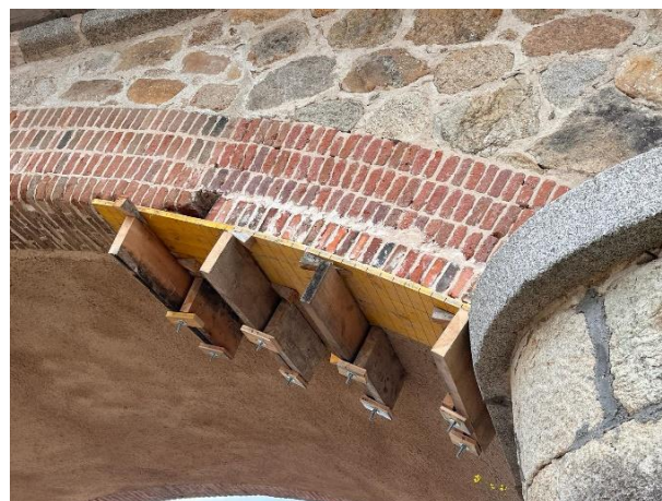
Figura 16. Reconstrucción de las roscas de boquilla
