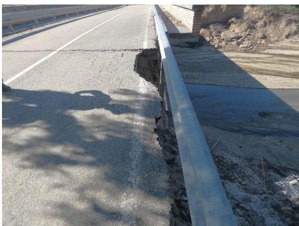
Figura 8. Descalce de la plataforma por pérdida de muro en estribo 1, lado aguas abajo
