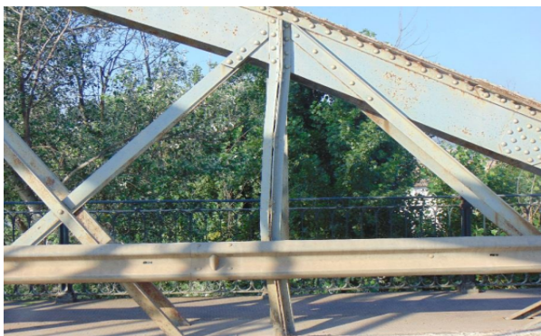
Figura 5. Montante deformado en celosía.
