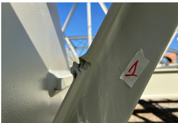
Figura 6. Daños por metralla de la Guerra Civil.
