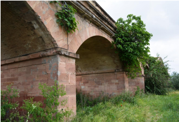
Figura 8. Estado inicial de vanos de fábrica, vegetación enraizada
