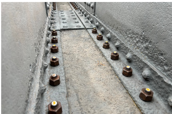
Figura 3. Corrosión por picaduras en cordones inferiores y unión entre perfiles.
