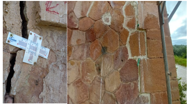
Figura 10. Fisura localizada en estribo 1.
