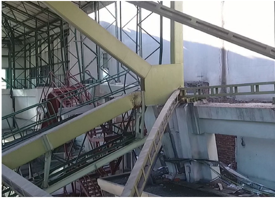
Figura 9. Desplome del pórtico principal de fachada.
