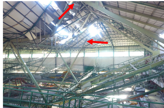
Figura 8. Rotura de las diagonales de las celosías principales.
