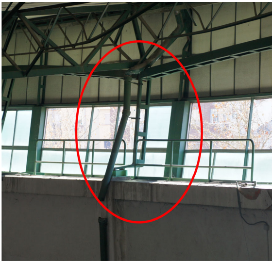
Figura 10. Desplome de pilares metálicos de fachada.
