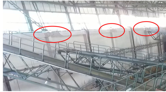
Figura 11. Caída de pasarelas de nivel intermedio.
