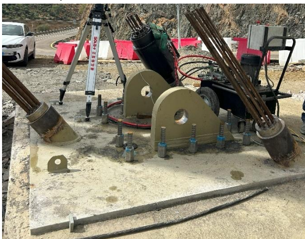
Figura 13. Anclaje de la retenida de la torre
