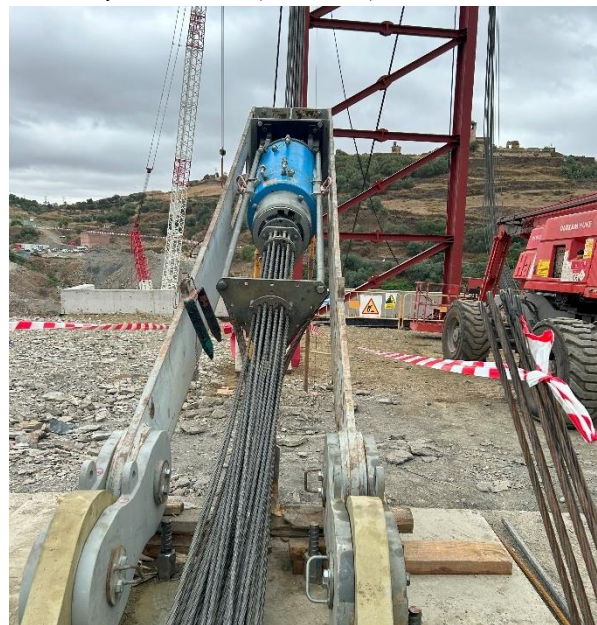
Figura 14. Anclaje de la retenida de la torre
