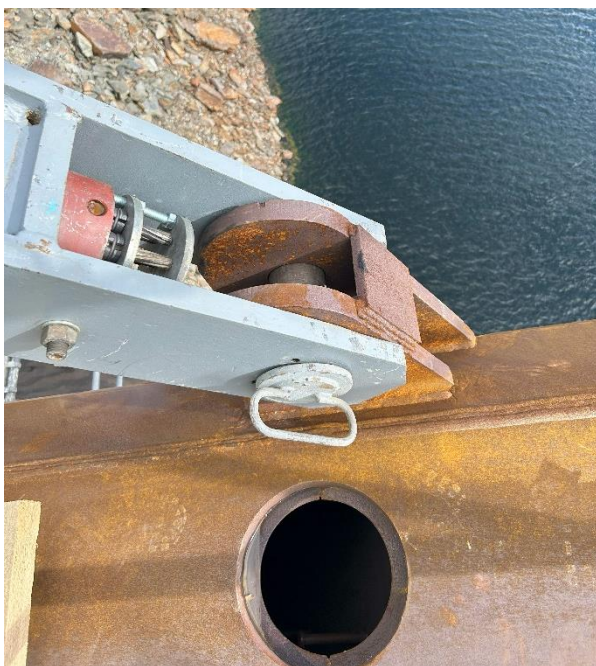
Figura 17. Orejeta de anclaje en el arco
