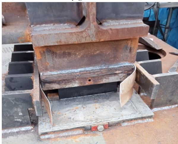
Figura 22. Neoprenos en estructura auxiliar
