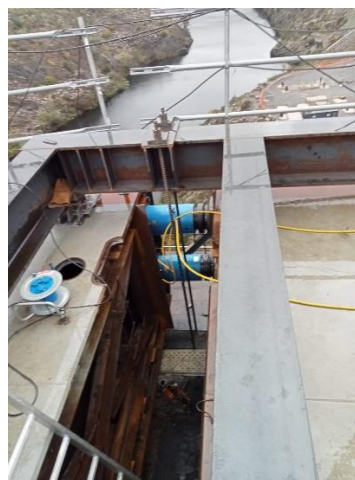
Figura 24. Estructura de bloqueo y gatos
